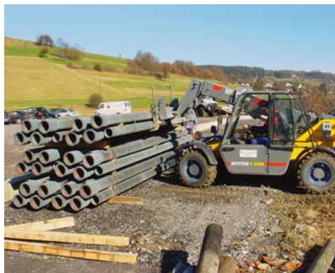
I pali vengono scaricati e movimentati sul cantiere per mezzo di muletti leggeri.
