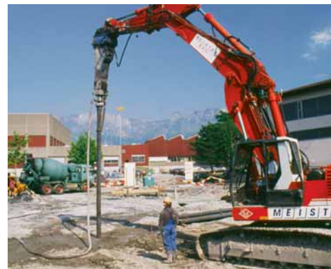
Impianto di cantiere semplice: escavatore con martello idraulico, betoniera, pompa per calcestruzzo, tubi.
